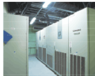
UPSシステム
