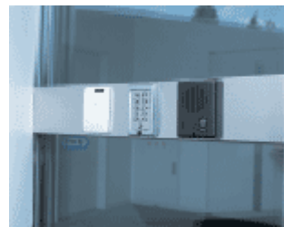
玄関口入退室管理
