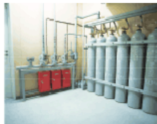
ハロゲン化物消化システム
