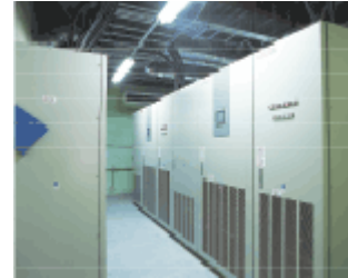
UPSシステム
